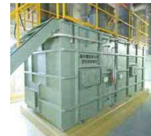
高中濃度・低濃度臭気用 活性炭吸着塔
