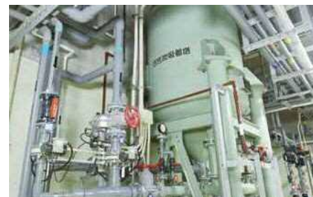
活性炭吸着塔
