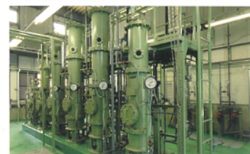
■高度処理設備
