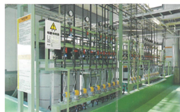
■薬液注入設備
