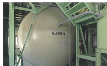
■生物処理設備
