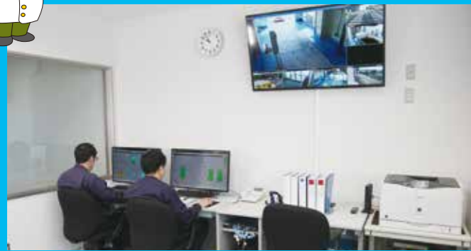
中央監視室 処理の流れや機械の運転状況を監視します。
